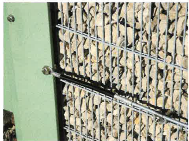
Bild [6] Übergang Korb Stahlprofil
