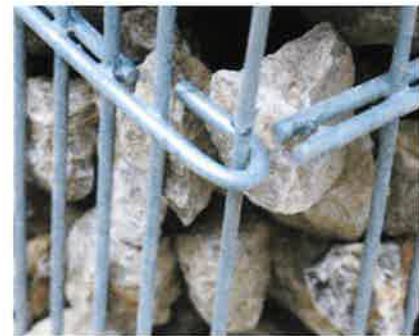
Bild [4] Punktschweißung an Kopfteil geplatzt
